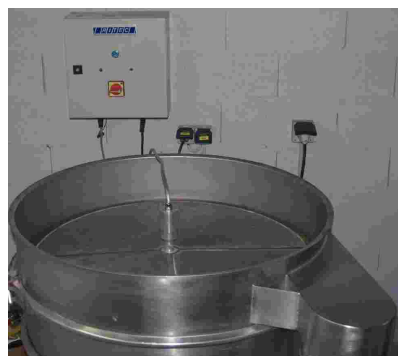
Système de décolmatage par ultrasons
